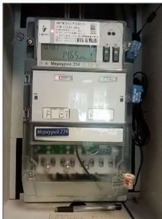
Рисунок 5.3.15 – Прибор учета электрической энергии
